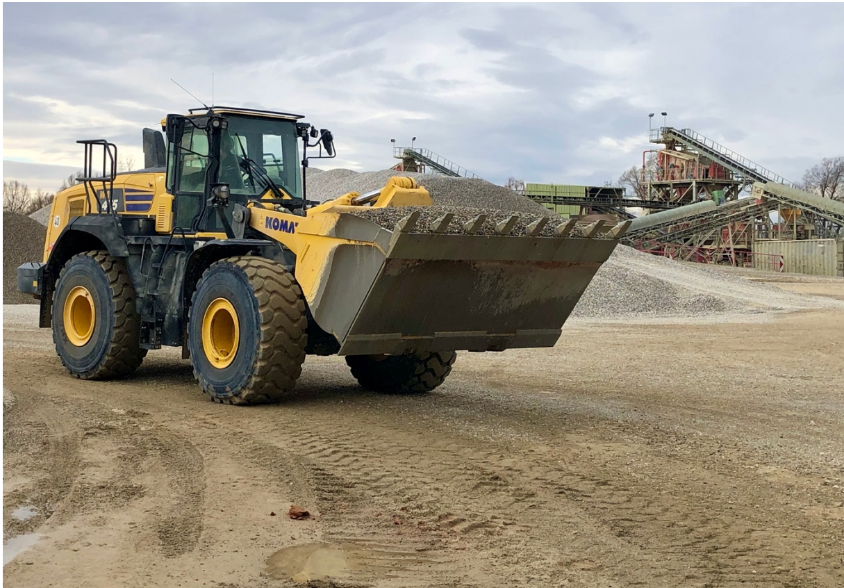
Bild 2: Die beiden Radlader WA475-10 werden im Kieswerk Kling zum umweltbewussten Kies laden eingesetzt.
