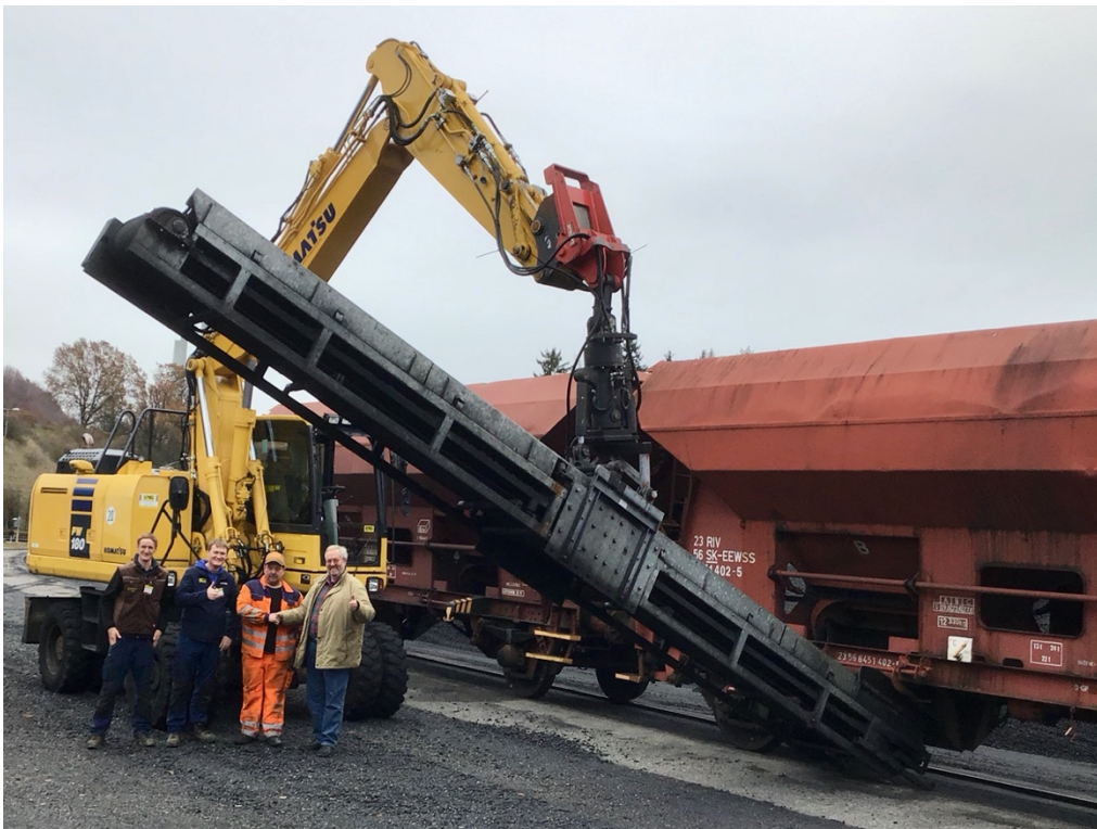
Bild 1: Um einen perfekten Arbeitsablauf bei der Entladung des Schwarzstoffes in Bahnbetrieb zu gewährleisten musste das vorhandene Förderband an den PW180 angepasst werden.
